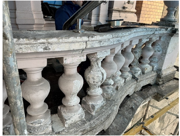
Рис. 4. Фрагментарний вигляд балясин центрального балкону після демонтажу аварійних зон
