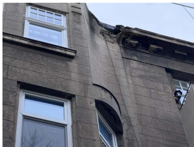
Рис. 4. Вул. Ковжуна, 4. Руйнування верхніх конструкцій
