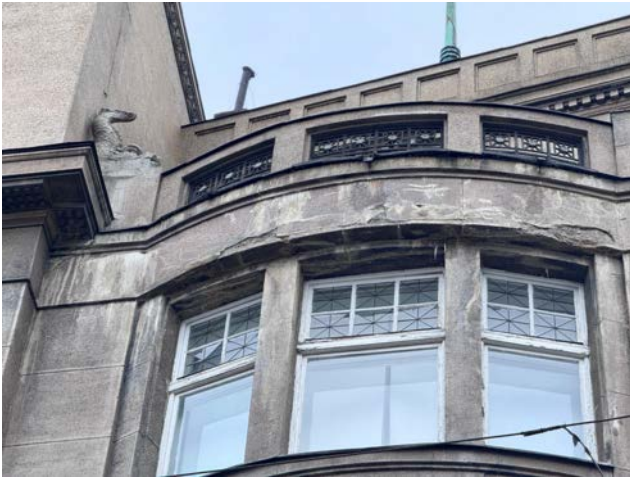
Рис. 5. Вул. Коперника, 4. Руйнування в зонах замочань
