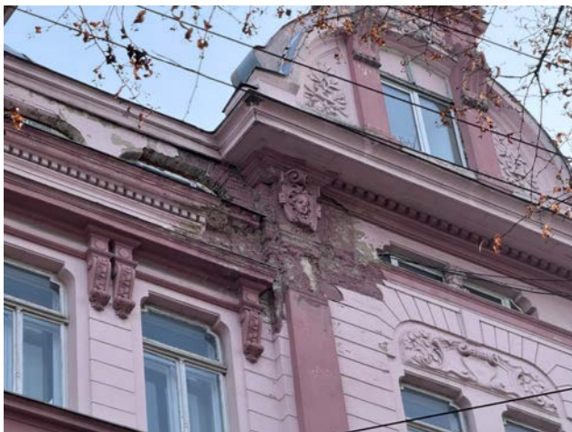
Рис. 2. Вул. Січових Стрільців, 11. Фрагмент фасаду. Пошкодження декоративного шару
