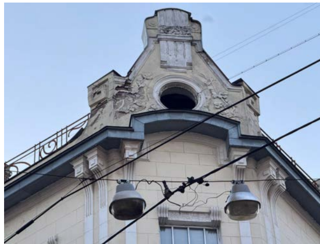
Рис. 3. Вул. Дорошенка, 20. Пошкоджені елементи сецесійного декору
