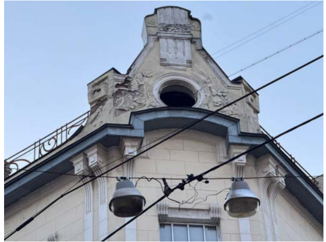
Рис. 3. Вул. Дорошенка, 20. Пошкоджені елементи сецесійного декору
