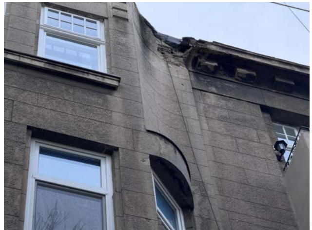
Рис. 4. Вул. Ковжуна, 4. Руйнування верхніх конструкцій
